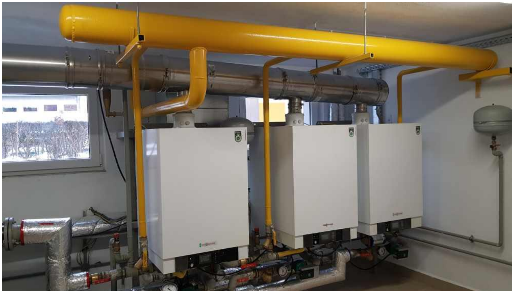
KOTŁOWNIA GAZOWA W BUDYNKU OS. 1000-LECIA 18
