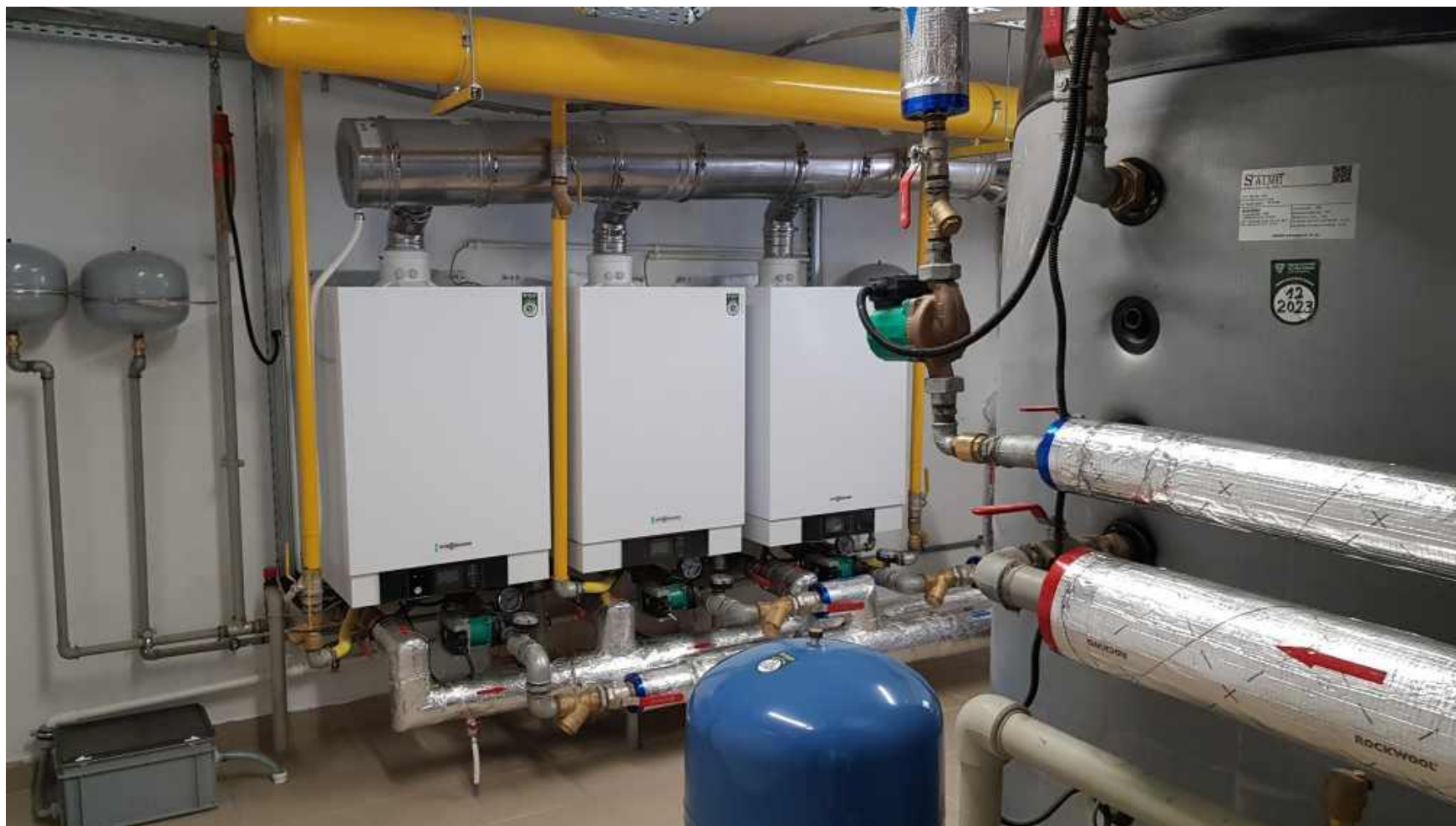
KOTŁOWNIA GAZOWA W BUDYNKU OS. 1000-LECIA 19
