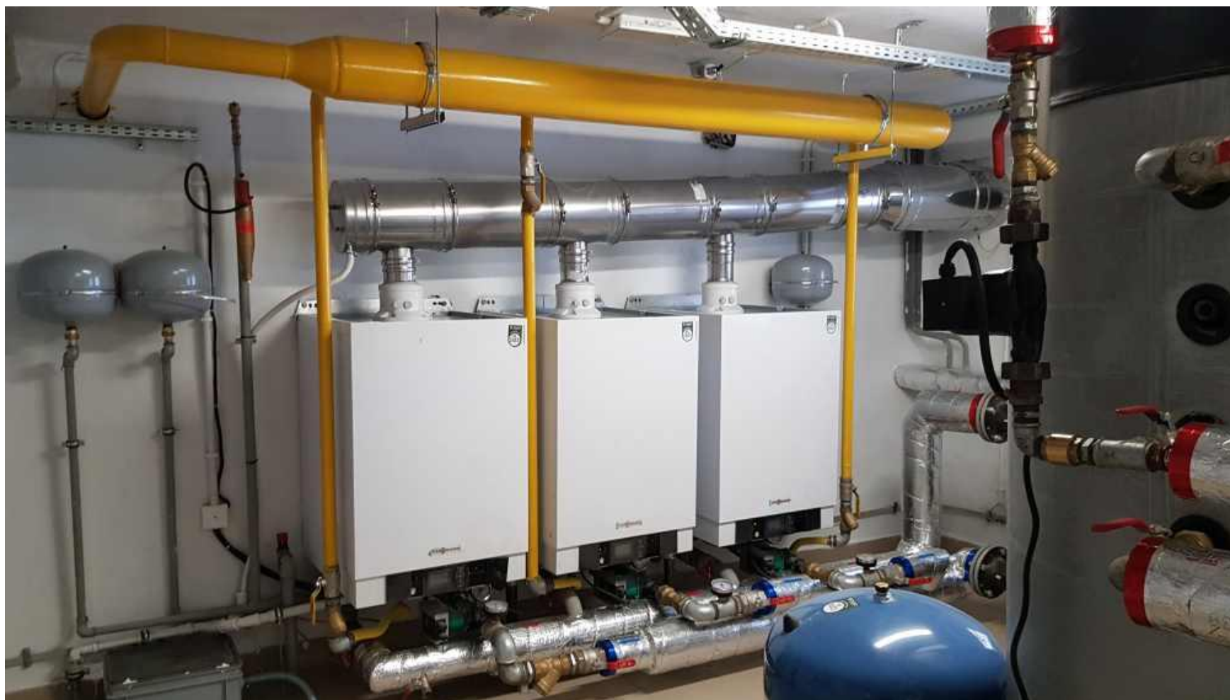
KOTŁOWNIA GAZOWA W BUDYNKU OS. 1000-LECIA 20
