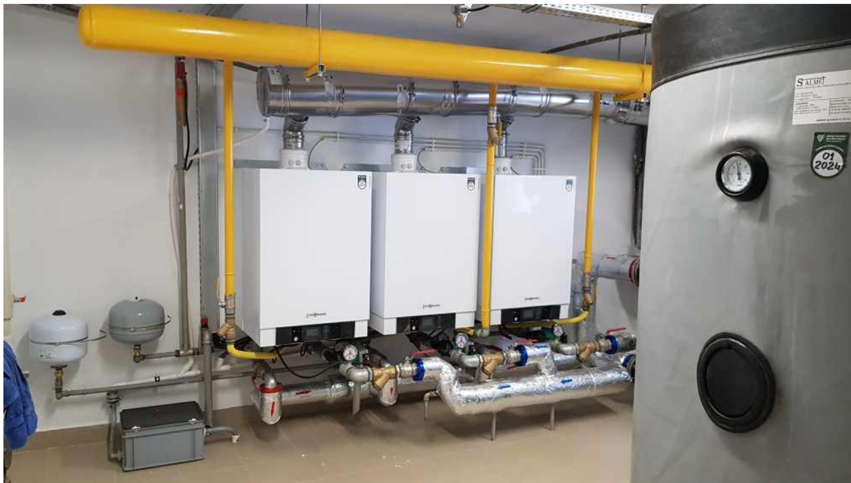
KOTŁOWNIA GAZOWA W BUDYNKU OS. 1000-LECIA 21
