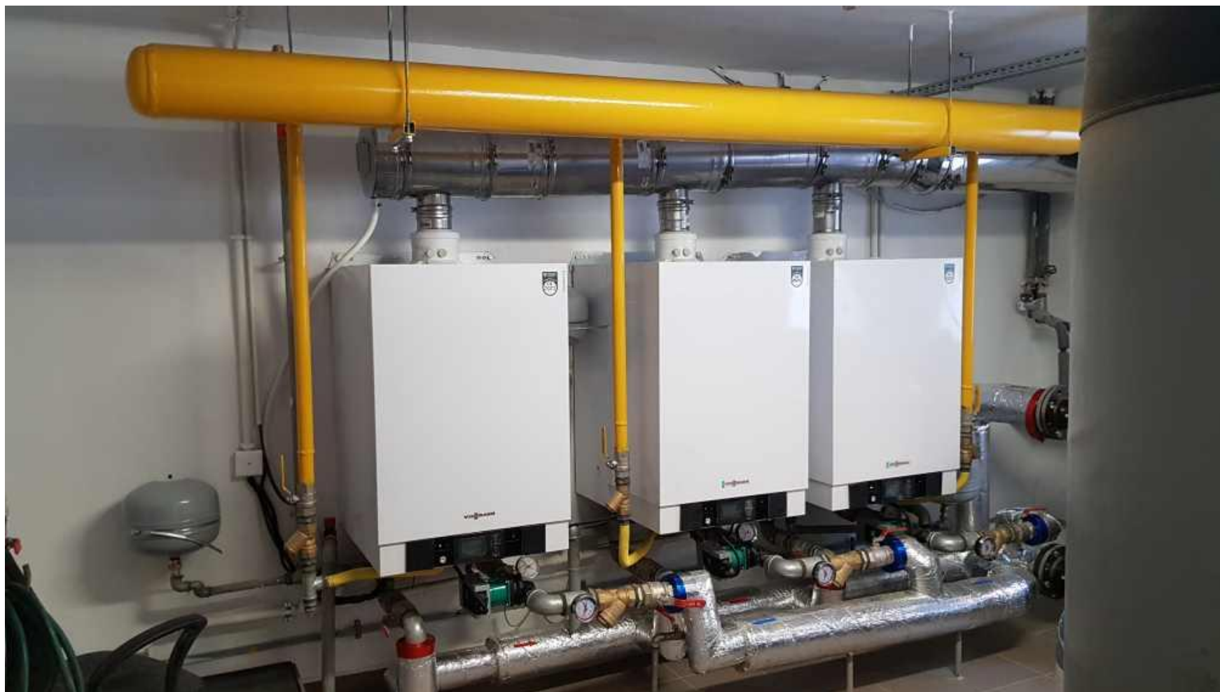
KOTŁOWNIA GAZOWA W BUDYNKU OS. 1000-LECIA 22
