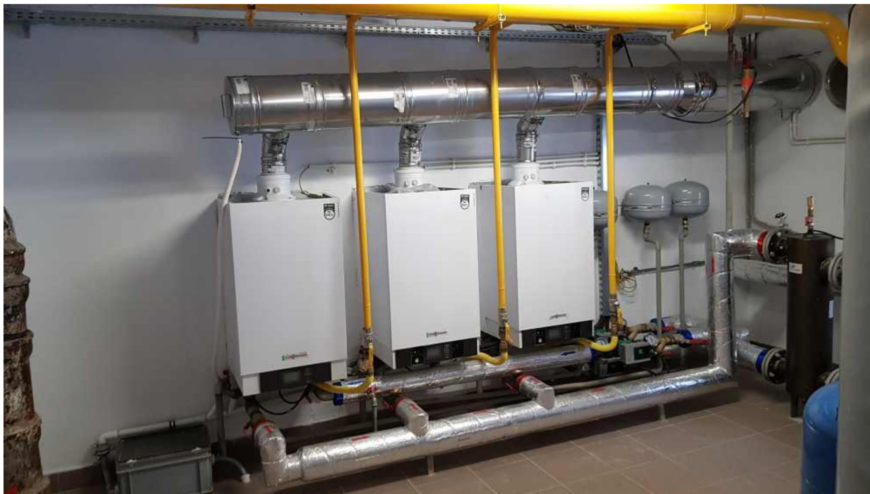
KOTŁOWNIA GAZOWA W BUDYNKU OS. 1000-LECIA 23
