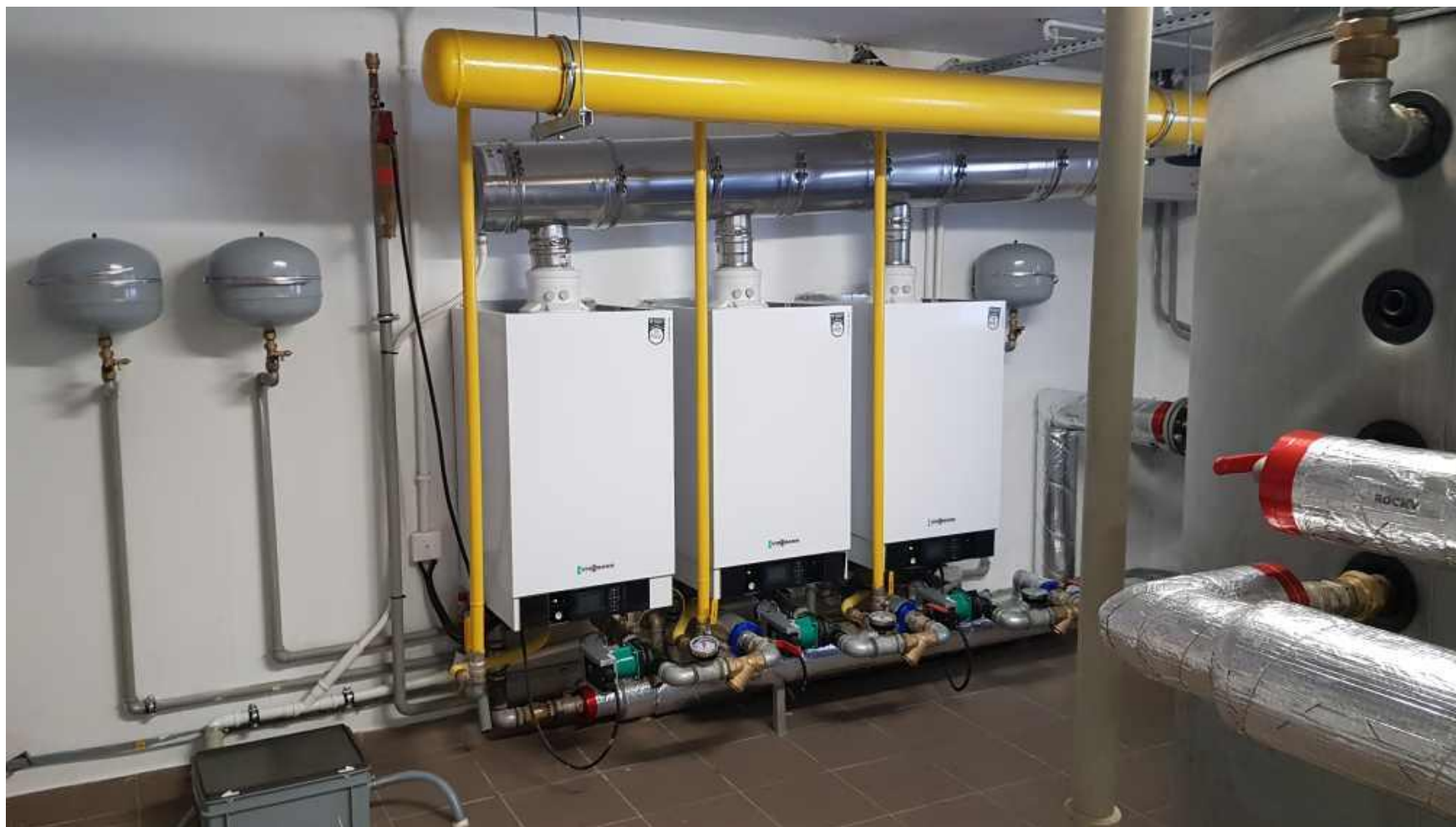
KOTŁOWNIA GAZOWA W BUDYNKU OS. 1000-LECIA 24
