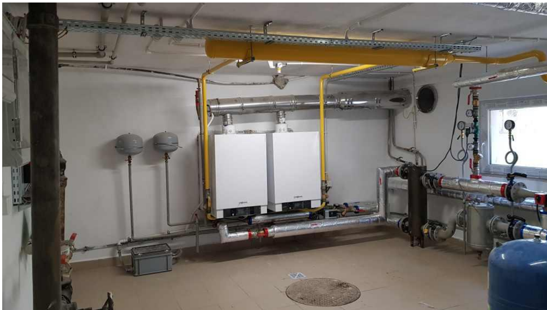
KOTŁOWNIA GAZOWA W BUDYNKU OS. 1000-LECIA 25
