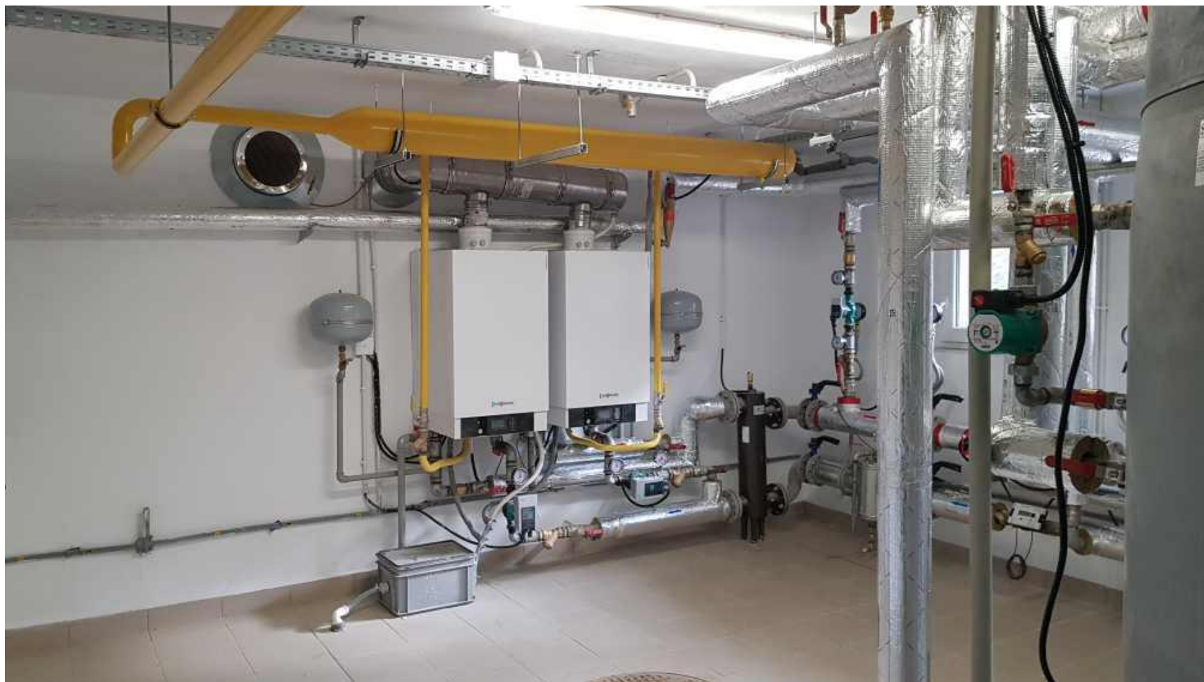
KOTŁOWNIA GAZOWA W BUDYNKU OS. 1000-LECIA 26
