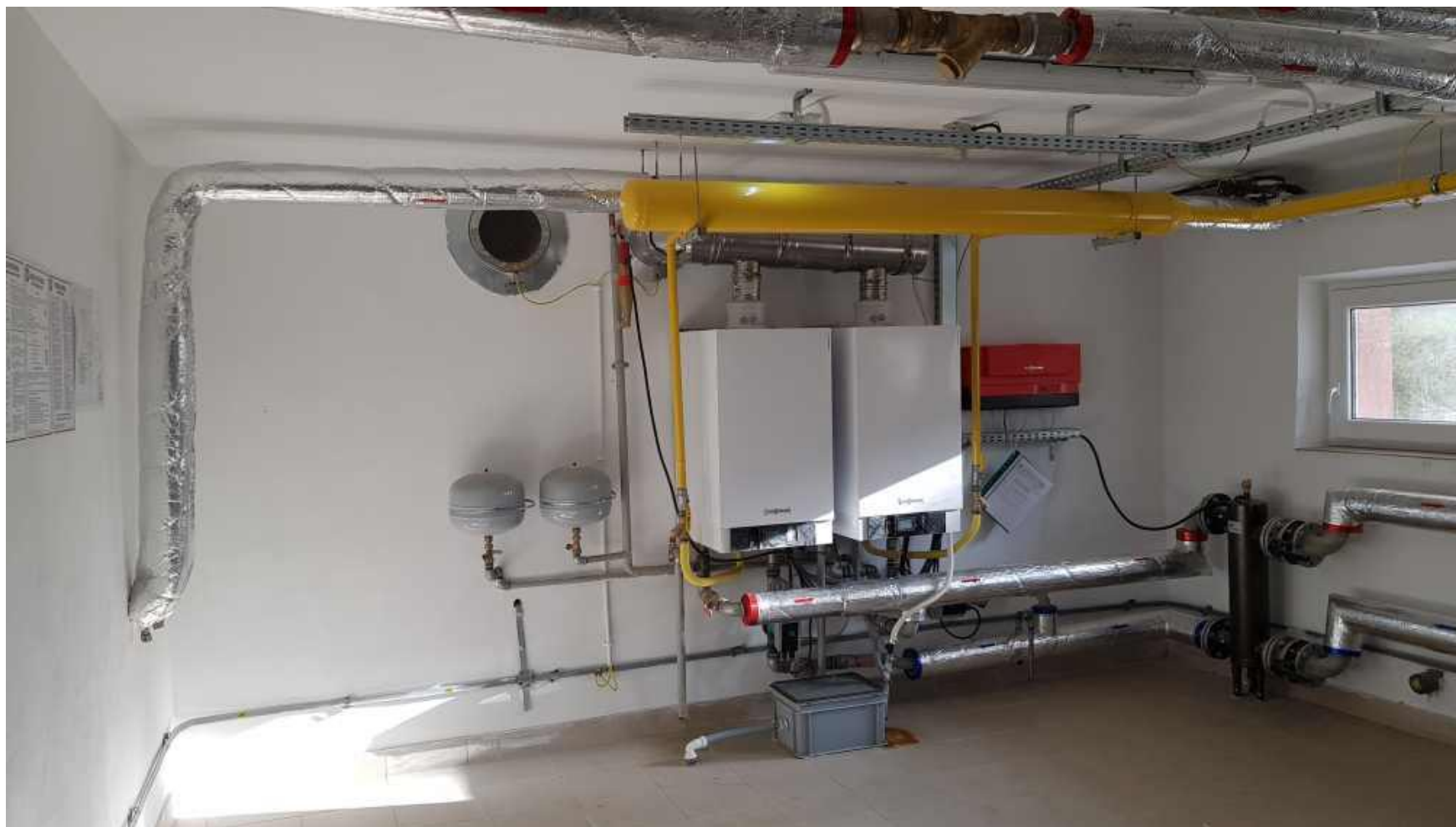
KOTŁOWNIA GAZOWA W BUDYNKU OS. 1000-LECIA 27
