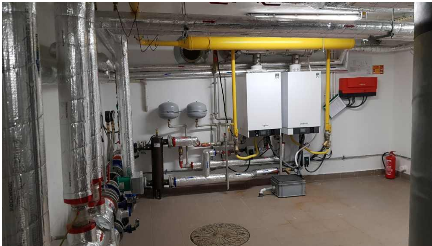
KOTŁOWNIA GAZOWA W BUDYNKU OS. 1000-LECIA 28
