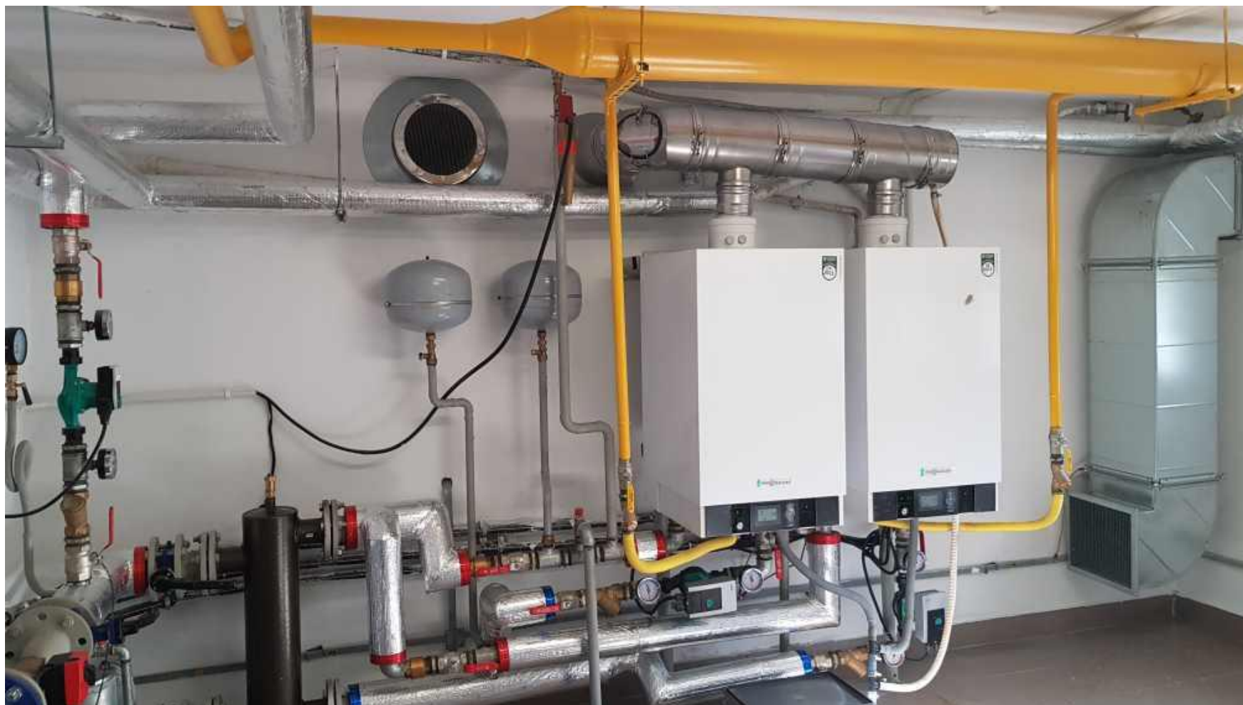
KOTŁOWNIA GAZOWA W BUDYNKU OS. 1000-LECIA 29
