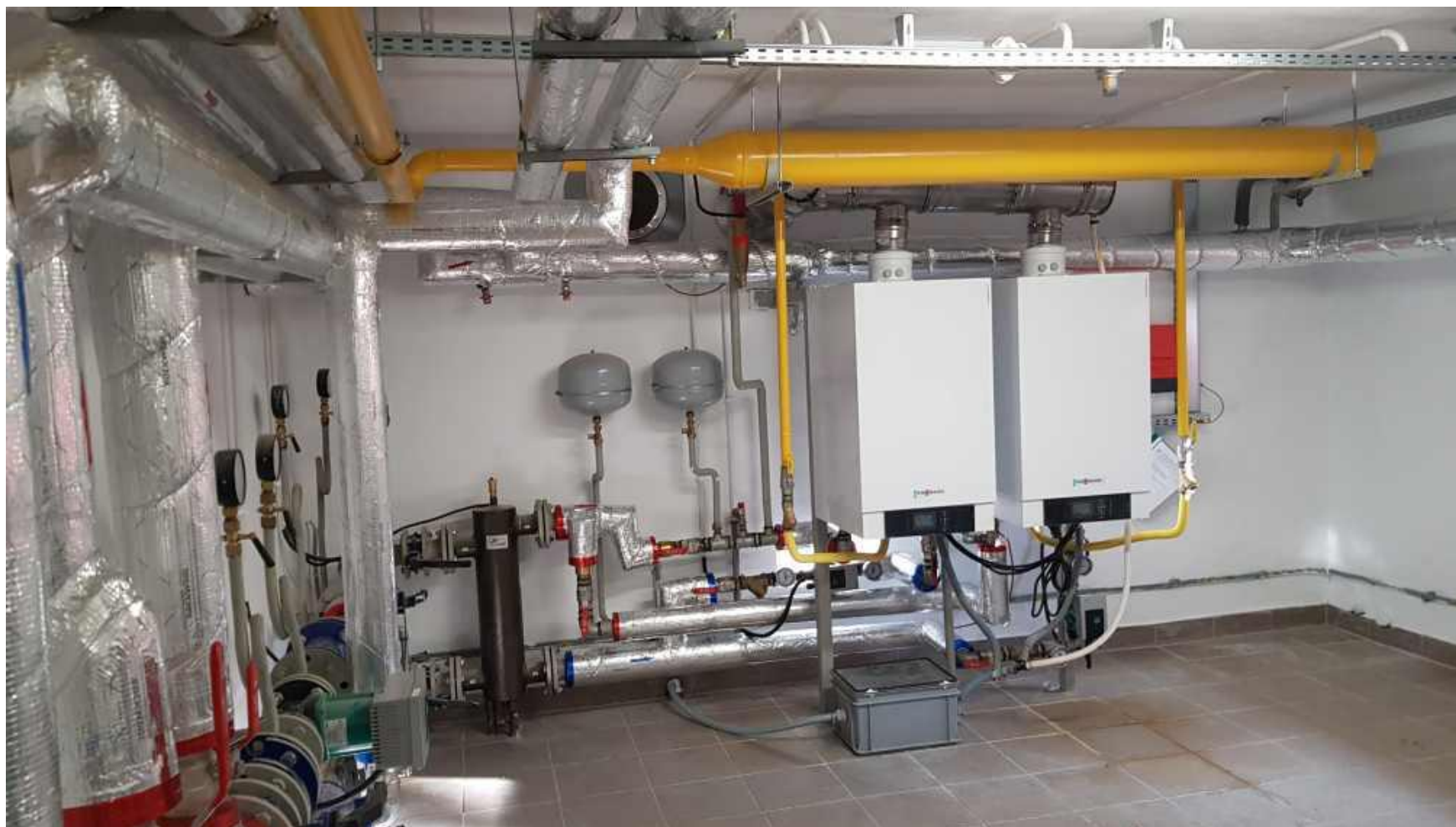
KOTŁOWNIA GAZOWA W BUDYNKU OS. 1000-LECIA 32
