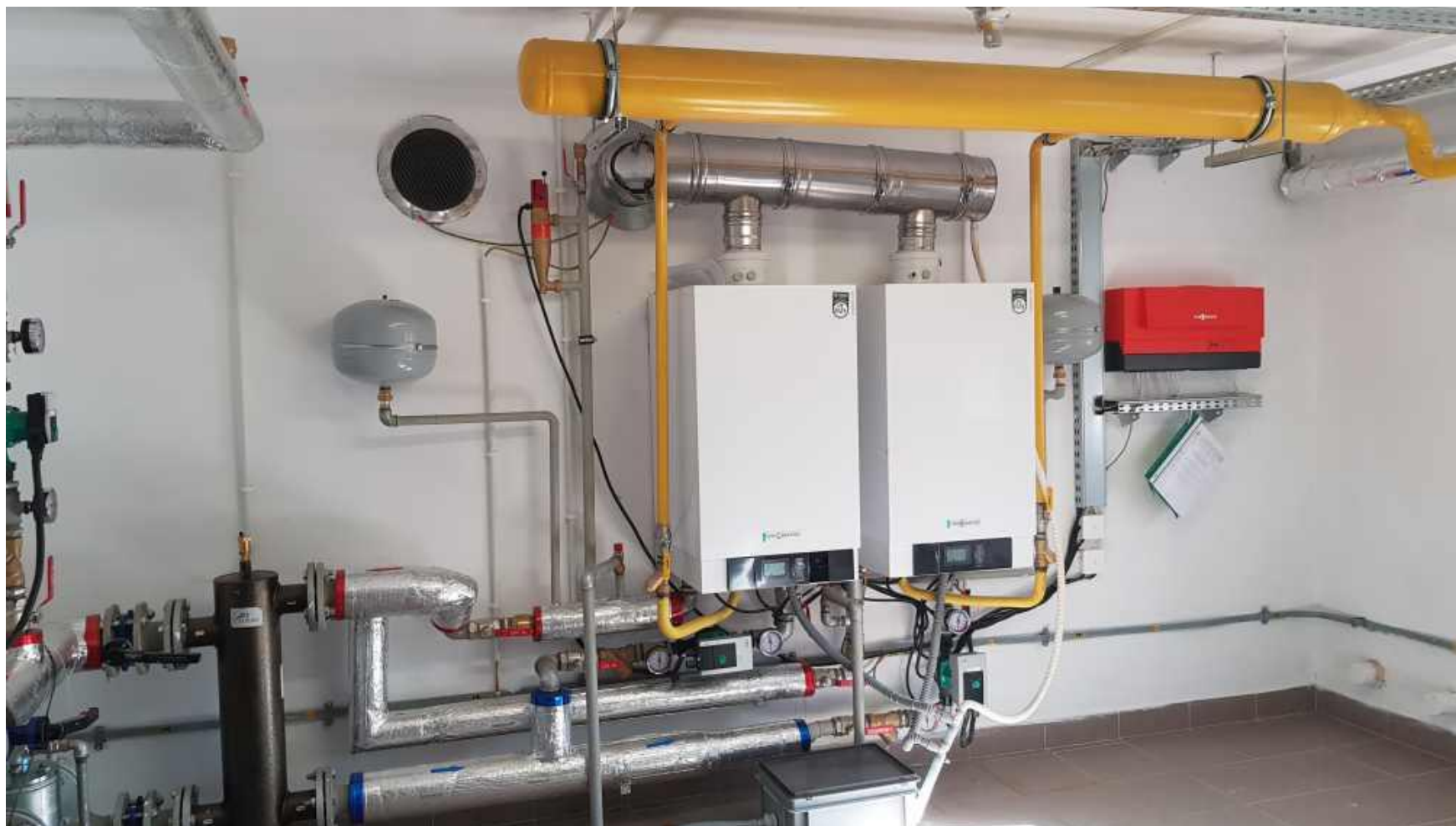
KOTŁOWNIA GAZOWA W BUDYNKU OS. 1000-LECIA 33
