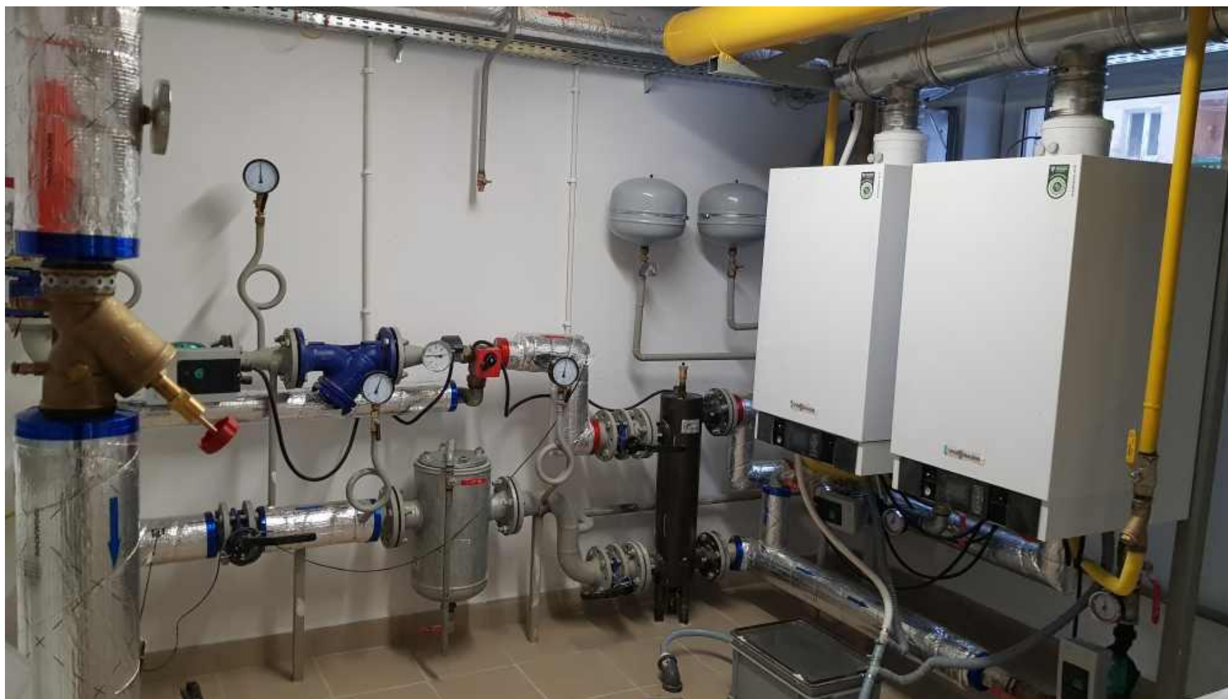
KOTŁOWNIA GAZOWA W BUDYNKU OS. 1000-LECIA 5
