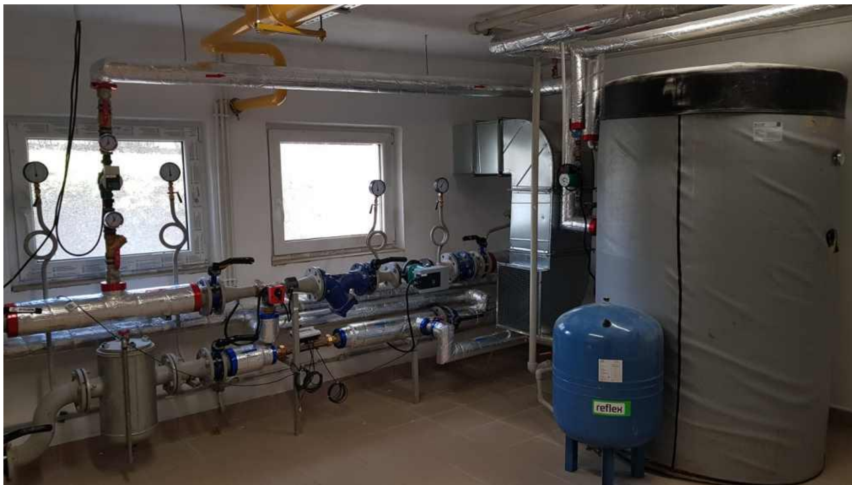
Zasobnik CWU oraz armatura nowej kotłowni gazowej
