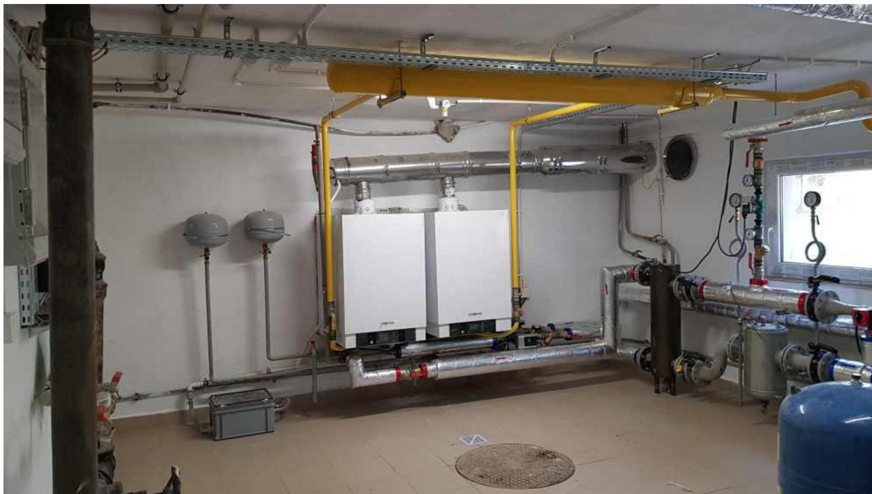
Pomieszczenie przyłącza CO i CW po rewitalizacji – KOTŁOWNIA GAZOWA
